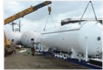
Cylindrical C-Type LNG Tanks
